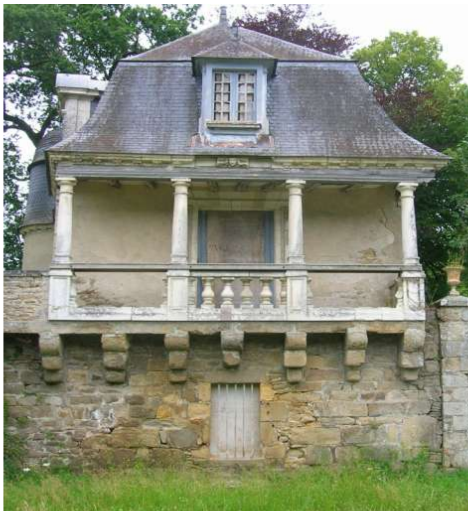
La Maison des confesseurs avant le chantier : on remarque l'état de la couverture, la loggia ayant perdu une bonne partie de ses balustres ainsi que la fenêtre percée ultérieurement et qui sera supprimée à la restauration.
